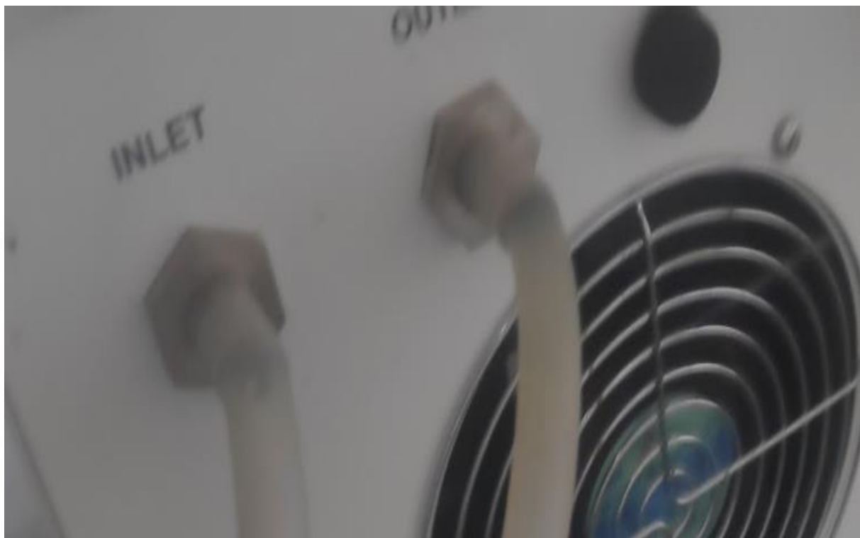
Figura 9 - Conexões Chiller (Parte traseira) - Sistema de refrigeração de água.
