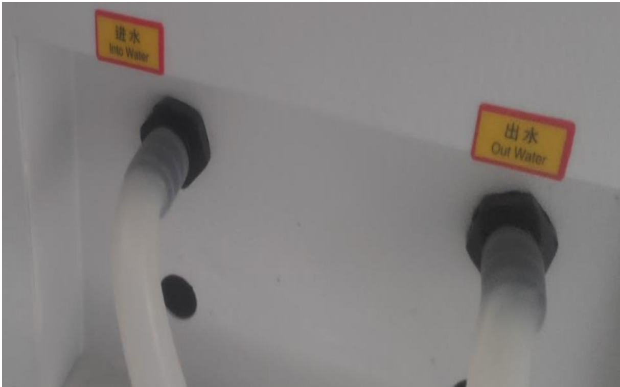
Figura 10 - Conexão Mafran (Parte traseira) - Sistema de refrigeração de água.
