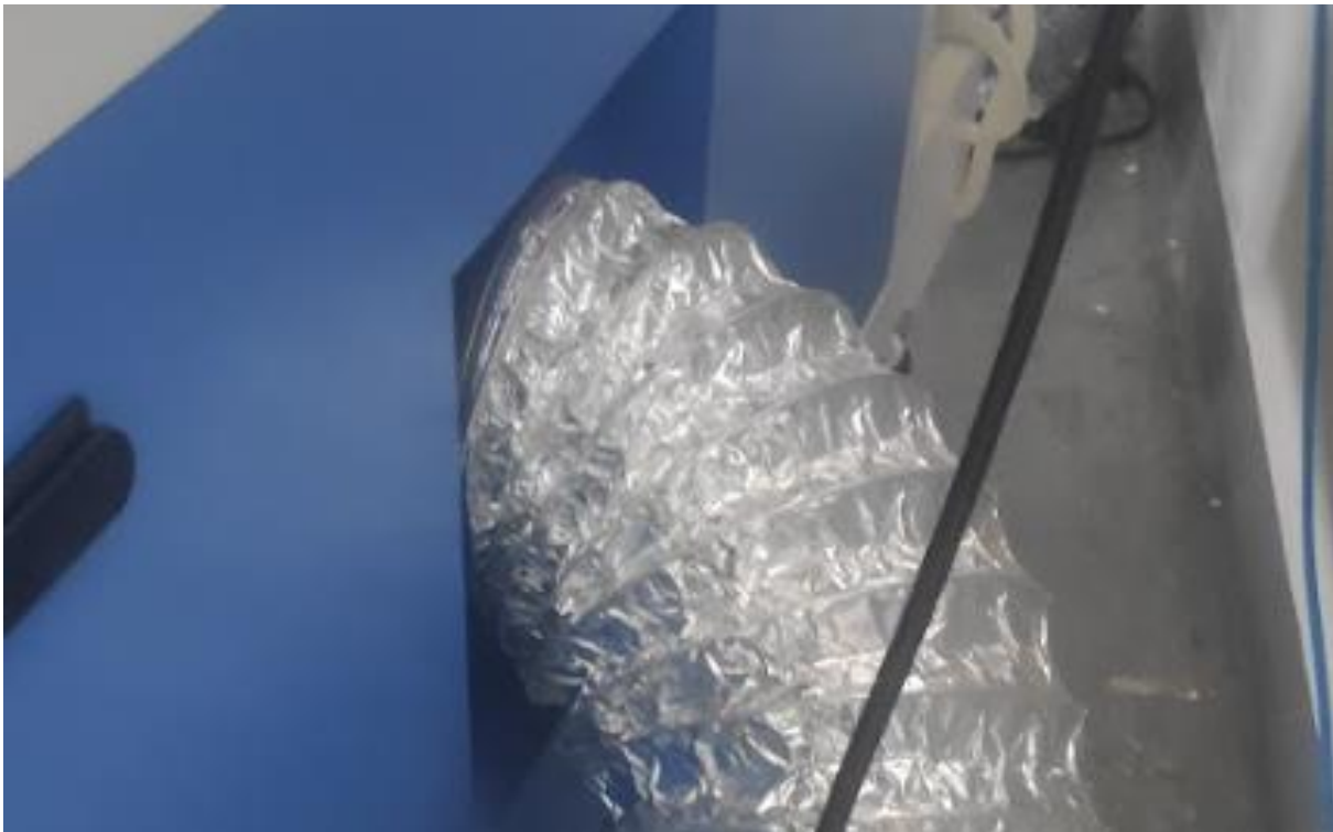
Figura 5 - Conexão entre contadora e exaustor (Parte traseira).
